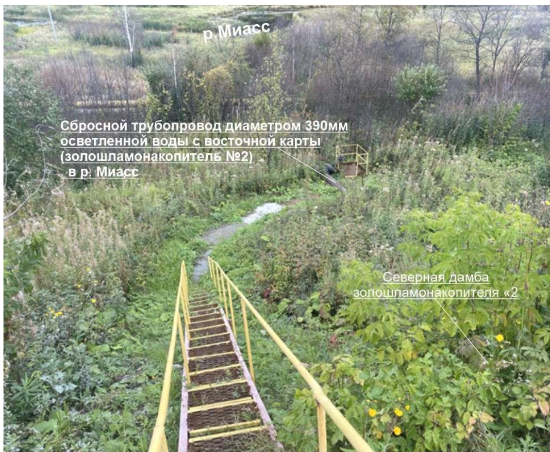
Рис.1.11 - Вид участка сбросного трубопровода \varnothing 390 мм. осветленной воды с восточной карты шламонакопителя (золошламонакопитель №2) в р. Миасс с лестничным переходом через дамбу и площадкой обслуживания отсечной задвижки на трубопроводе
