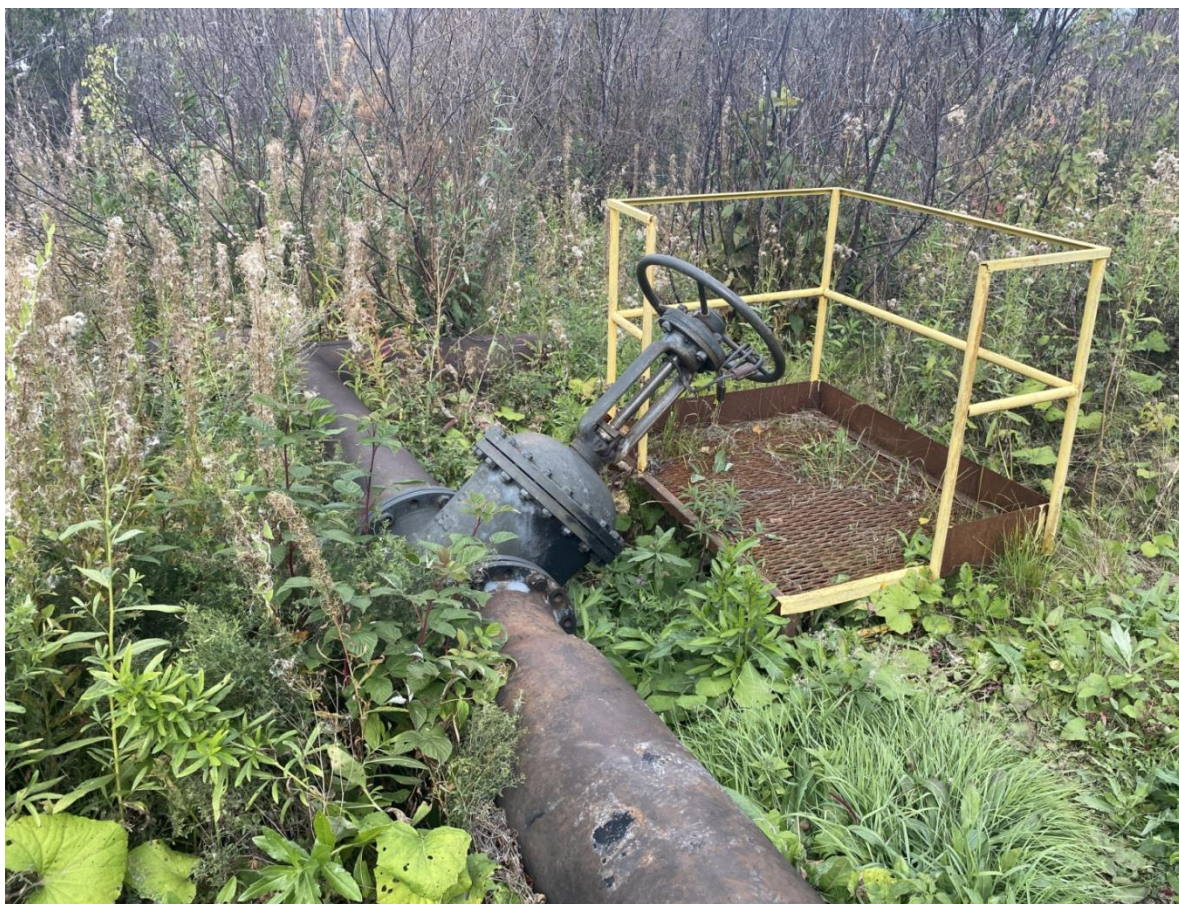
Рис. 1.12 - Отсечная задвижка на сбросном трубопроводе осветленной воды в р.Миасс с площадкой обслуживания
